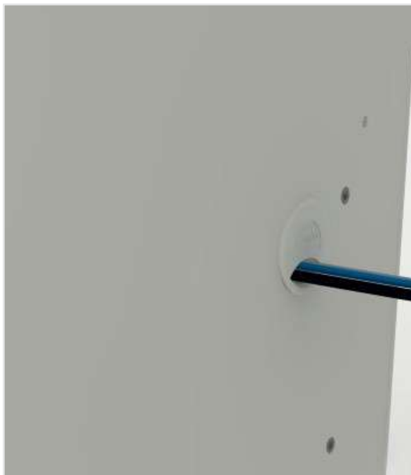
Detalhe da entrada da fiação
